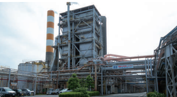
黒液回収ボイラ
