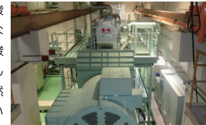
三島工場ガスエンジン発電機
